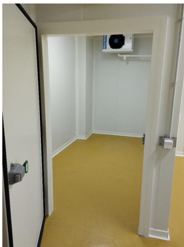
Chambre froide n°2
